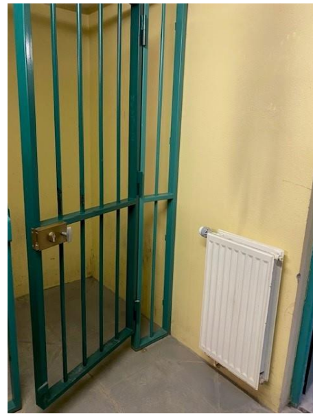
Le seul radiateur pour chauffer la zone de sureté
