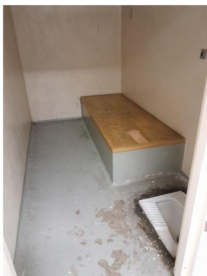
Cellules de la première zone équipées d'un WC à la turque avec sol nécessitant d'être refait
