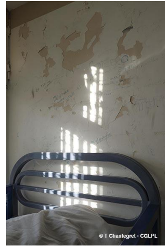
12 Mur dégradé au-dessus du lit
