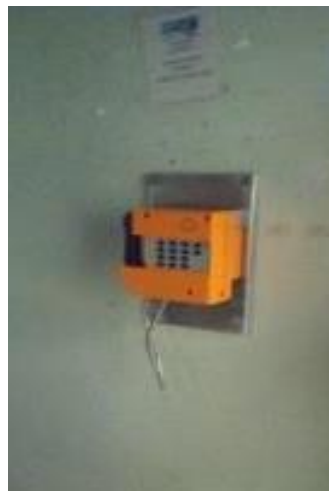
Un poste téléphonique dans une zone de vie
