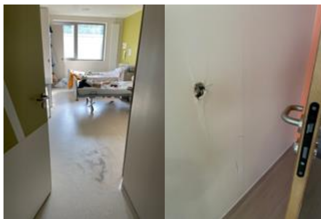
Marques d'usure ou de détérioration dans les chambres
