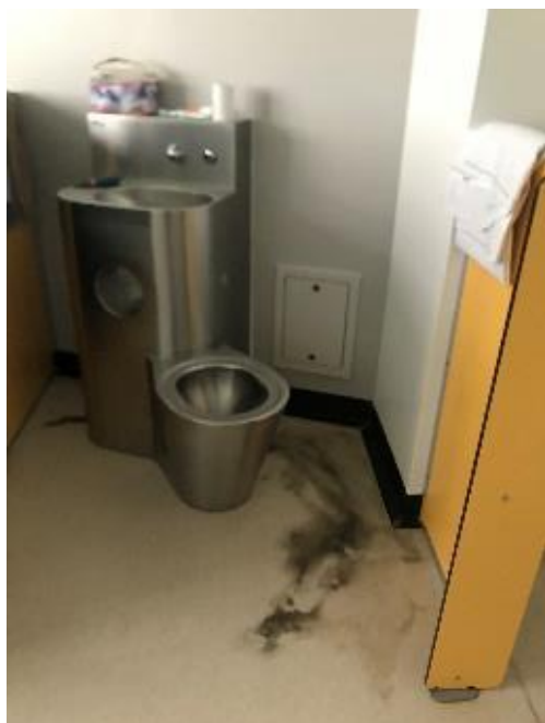
WC en inox dans la chambre d'un mineur USM1
