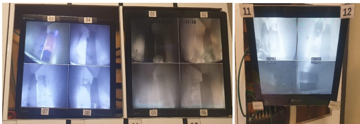
Report des images des caméras au poste et sur le bureau du garde-détenus
