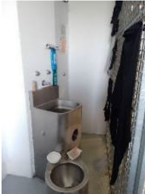
Bloc sanitaire d'une cellule disciplinaire
