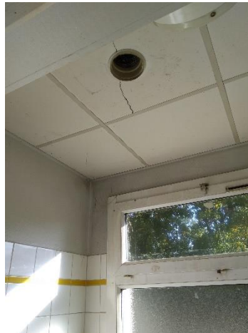
Plafond de sanitaire
