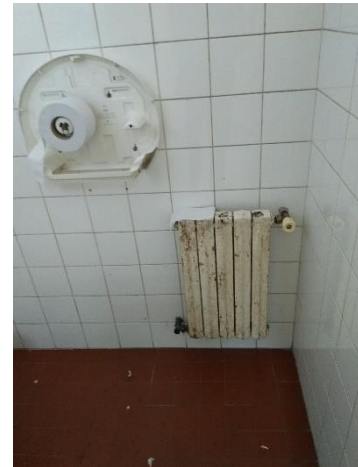
Radiateur et distributeur de papier toilette
