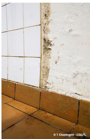
16 Humidité sur pans de murs de la cellule QSL
