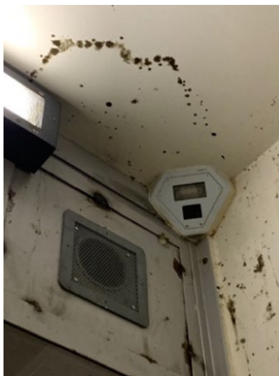
Moisissure au plafond de la cellule collective
