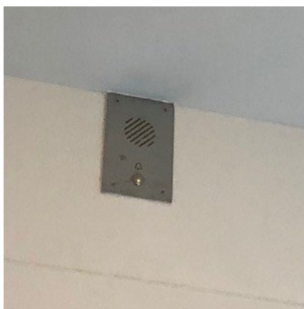
Micro et bouton d'appel situés dans l'angle du plafond de la CI
