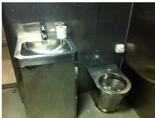
Le WC et le lavabo d'une cabine sécurisée
