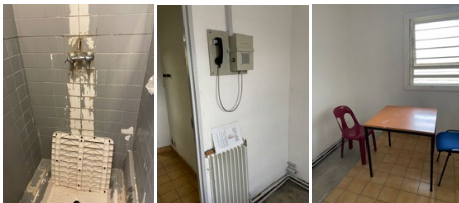
Douche du QD (à gauche) ; bureau d'entretien avec point phone adjacent à la douche
