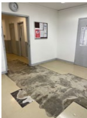
Revêtement du sol détérioré et contenant de l'amiante dans les colles
