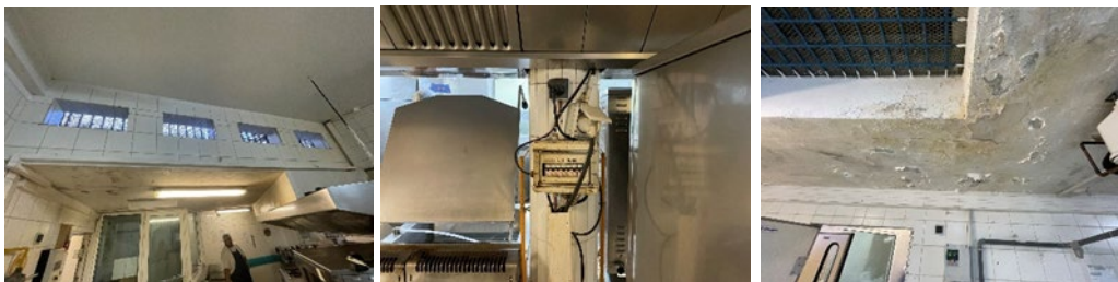
Aérations où s'écoule l'eau souillée, boîtier électrique dangereux et plafond de la salle de découpe
