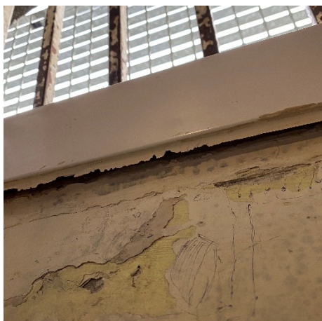
Infiltrations d'eau pluviale
