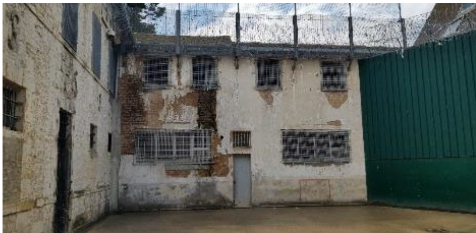
Etablissement vieillissant nécessitant de nombreux travaux de maintenance
