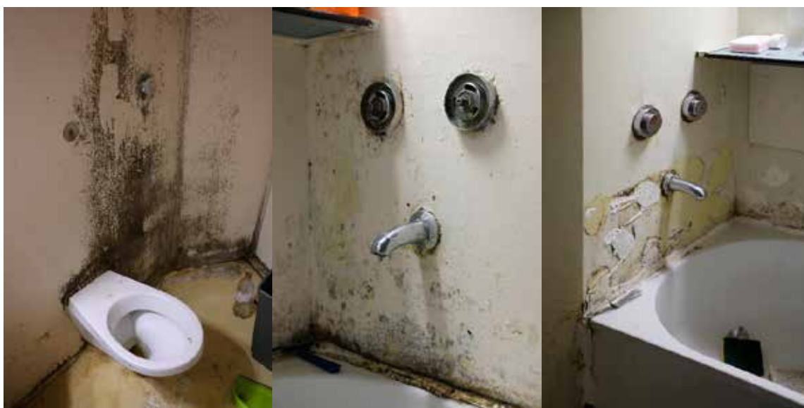
Sanitaires en cellule de la maison d'arrêt des hommes
