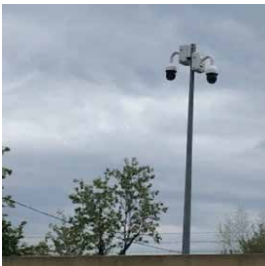
Les caméras de vidéosurveillance disposées sur le parking
