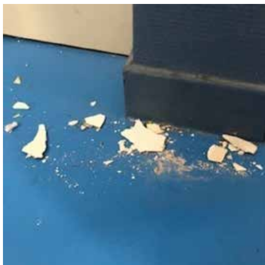
Des débris de murs effrités sur le sol des sanitaires
