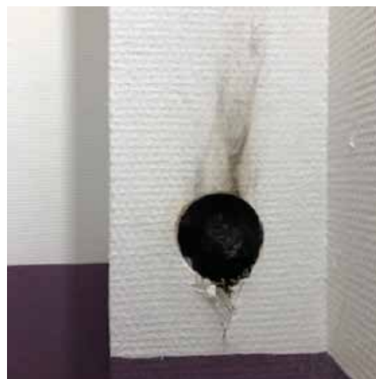
L'orifice non protégé d'un conduit dans un couloir
