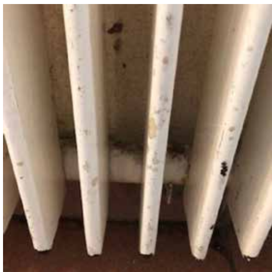
L'état de saleté avec de la poussière et des toiles d'araignée entre les lames du radiateur du réfectoire
