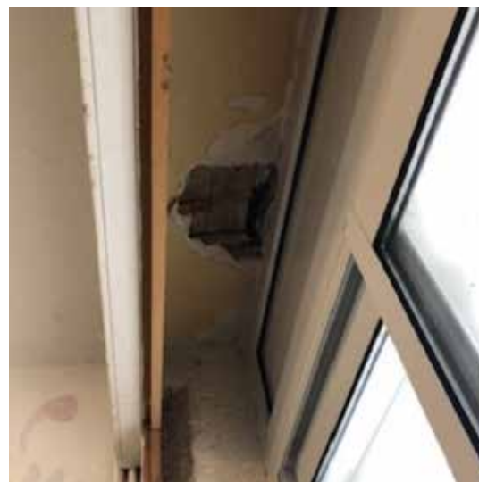
Le délabrement du plafond au-dessus de la fenêtre du réfectoire
