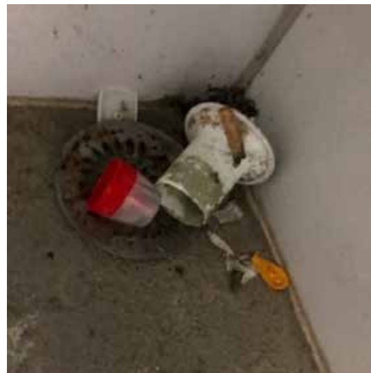
Les souillures et les débris sur le sol d'une douche des sanitaires
