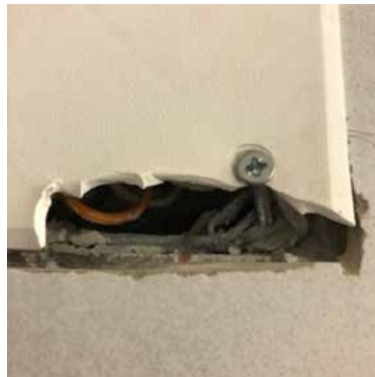
Un cache dégradé du système électrique désormais apparent et accessible
