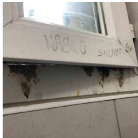
Les souillures et les graffitis sur et autour de la fenêtre des sanitaires
