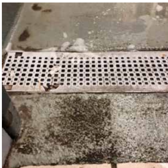
La saleté persistante du sol de la cuisine immédiatement après son nettoyage à grande eau
