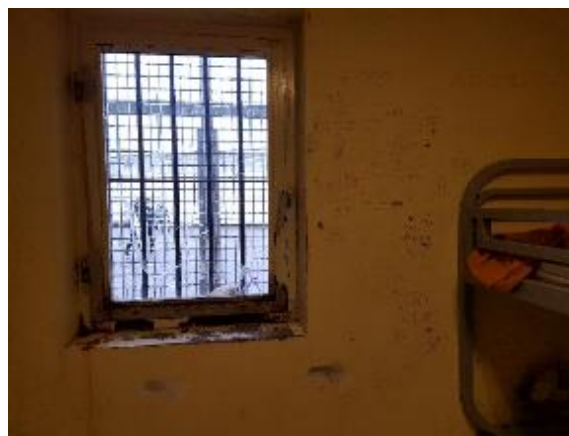
Ecoulement d'eau le long d'une fenêtre au QA-H
