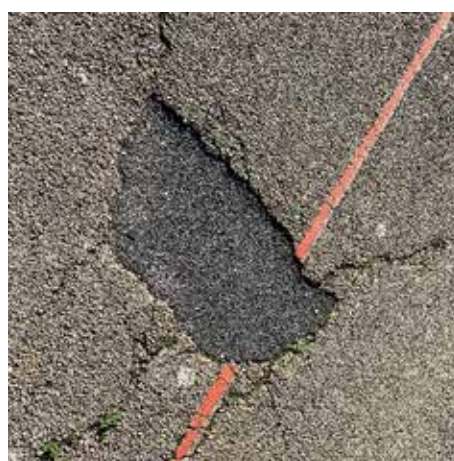
Dégradation du terrain de basket-ball
