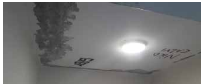
Peintures nécessitant d'être reprises
