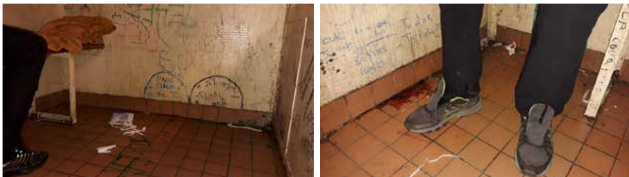
Hygiène et vétusté de la cellule n° 1 de garde à vue (deux occupants lors du contrôle)
