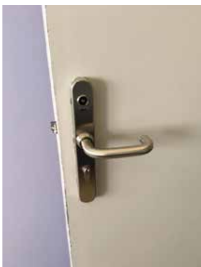
Dispositif SALTO ® sur porte de chambre Aile Ouest
