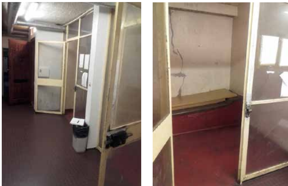
Entrées des trois cellules (à gauche), cellule de garde à vue (à droite)
