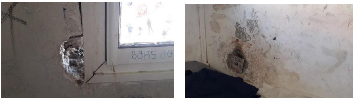
Cloisons au QM : à g., trou au niveau d'une fenêtre ; à d., renfort métallique près d'un lit
