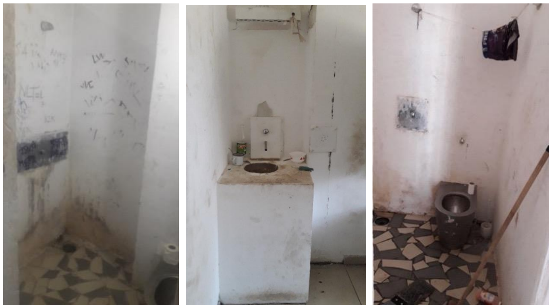
Sanitaires et lavabo de cellules du QM occupées le jour du contrôle
