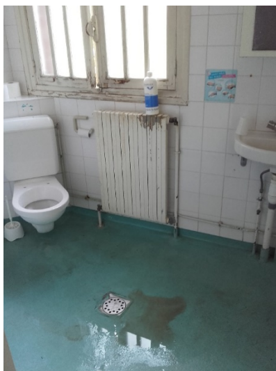
Une salle d'eau vétuste avec un problème d'évacuation d'eau (unité Duchamp)
