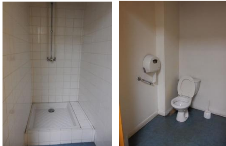
Douche et toilette
