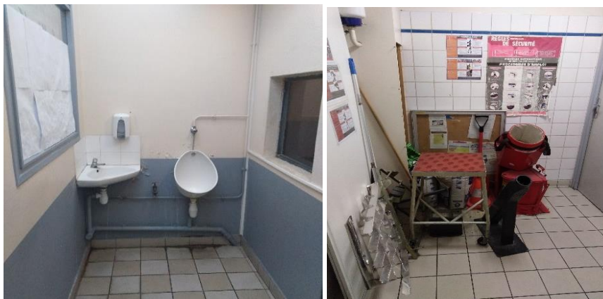
Urinoir et lavabo situés dans le sas des deux cellules- Local des toilettes du personnel
