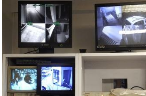
Figure 5 : déport d'images de vidéosurveillance sur les moniteurs du poste
