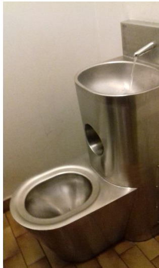
Le WC avec lavabo intégré pour les personnes des cellules de garde à vue, à proximité des geôles
