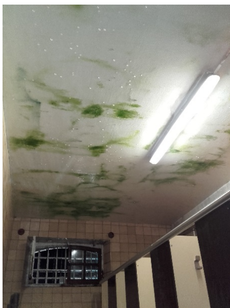
Moisissures vertes, plafond des douches
