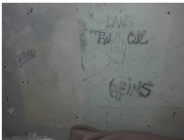
Mur sale le long du lit inférieur
