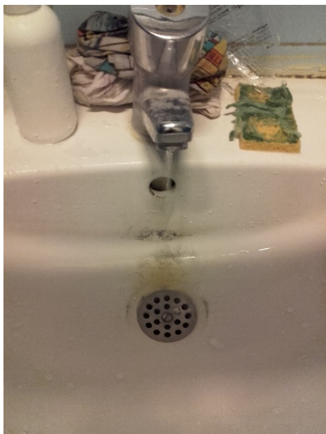
Robinet qui coule en permanence dans une cellule
