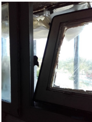
Fenêtre qui ne ferme plus dans une cellule d'isolement
