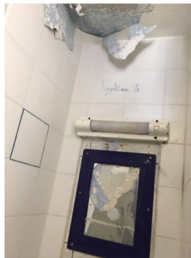
Miroir cassé et plafond délabré
