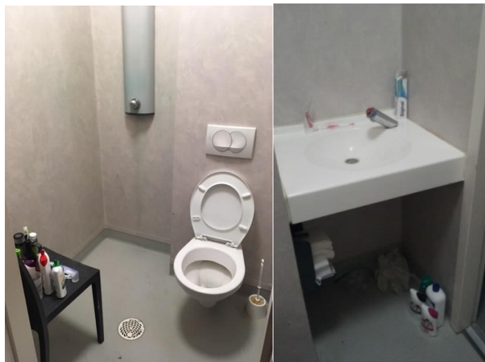
Absence d'étagère et bouton poussoir de robinet endommagé
