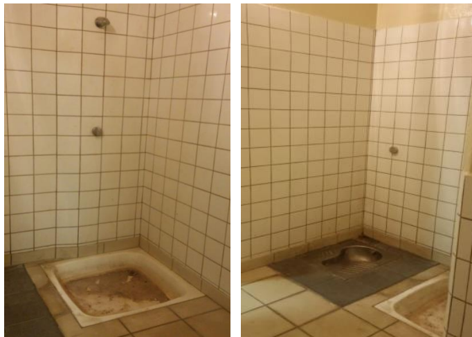
La douche hors d'usage et le WC
