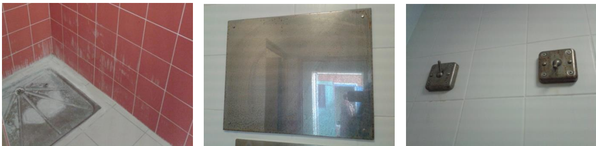
Signes de vieillissement des équipements sanitaires
