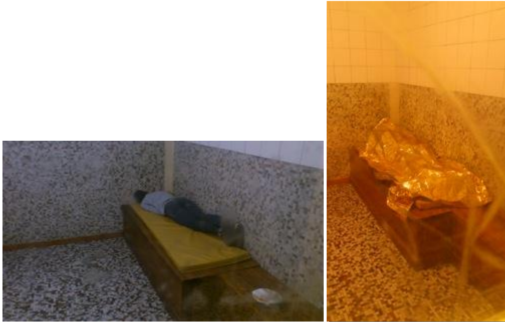
Banquettes des cellules de garde à vue avec utilisation de couverture de survie
