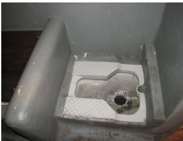
Chasse d'eau d'une chambre de dégrisement
