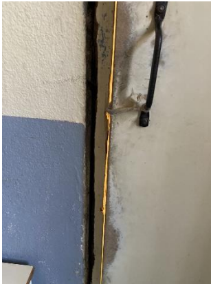
Porte de douche endommagée
