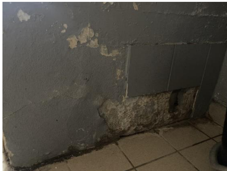
Mur endommagé par l'humidité
