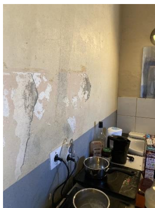
Cellule 24, traces de moisissure
