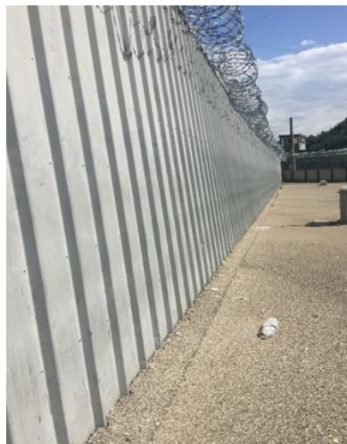
Mur de séparation des deux cours de promenade risquant de s'écrouler
