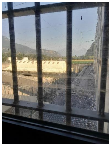
Débris sur les toits-terrasses
