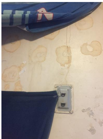
Traces d'humidité sur le mur d'une cellule
