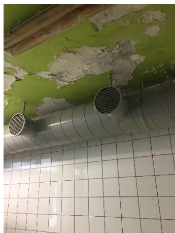
Système d'aération des douches du 1 er étage
