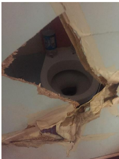
Cloison d'un espace WC cassée
