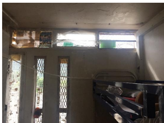
Fenêtres sans vitres protégées par du plastique
