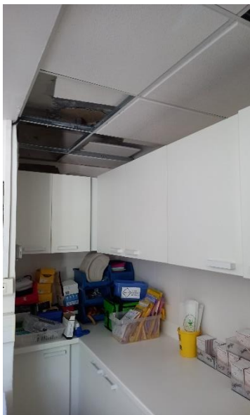
Faux plafond cassé en salle de préparation
