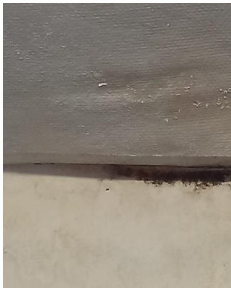
Moisissure au plafond de la salle de consultation médecin
