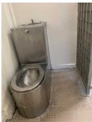
WC, cellule QD
