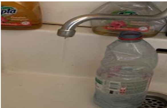
Robinet qui fuit à jet continu
