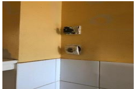
Fils électriques dénudés
