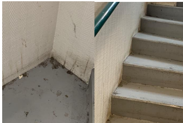
Les escaliers sont particulièrement mal entretenus
