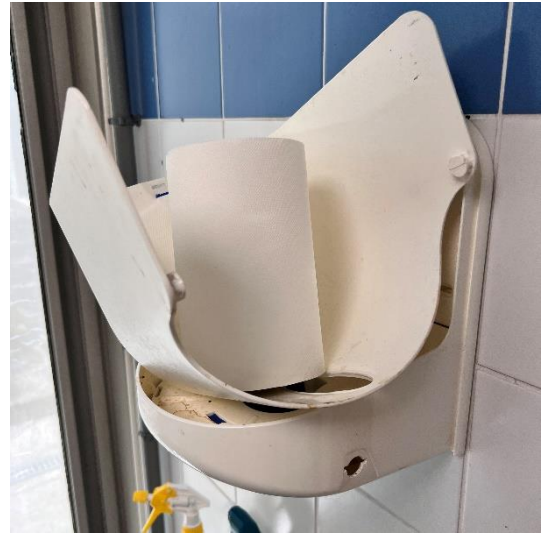
Dévidoir de papier dégradé
