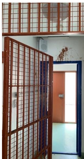
Entrée cellule QD
