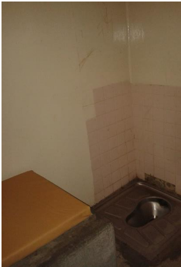
Commissariat : WC dans la cellule IPM
