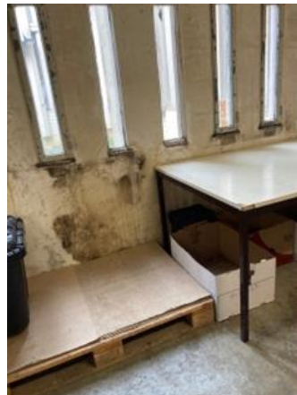
Etat du mur
