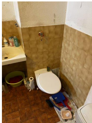
Toilettes en cellule au bâtiment C, moisissures et absence de séparation
