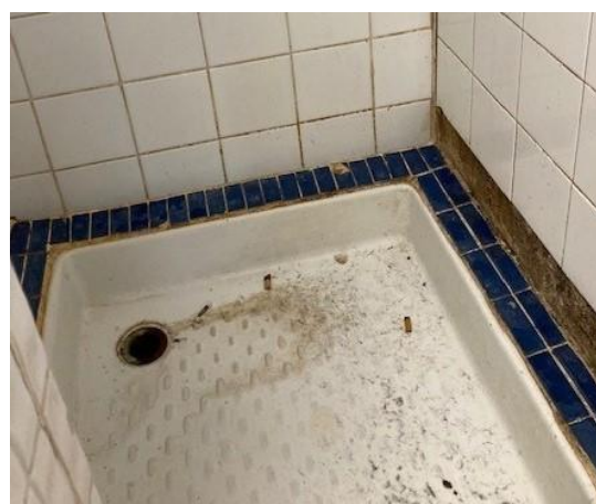
Aperçu d'un bac de douche avec mégots bâtiment A
