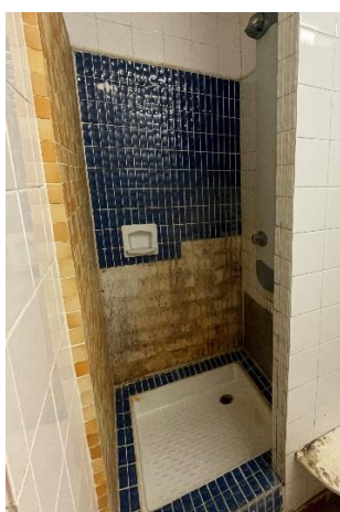
Douche avec carreaux tombés, bâtiment B
