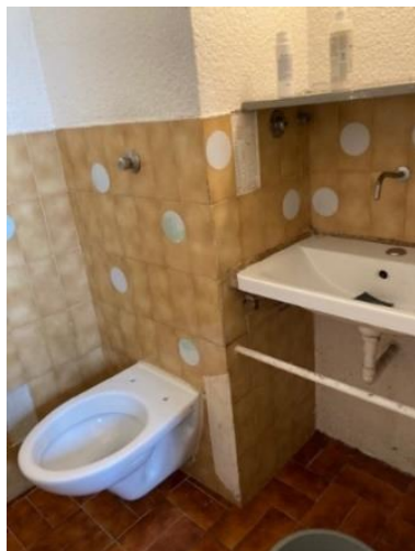
Espace sanitaire en cellule au bâtiment A avec absence de lunette, de séparation, carreaux tombés
