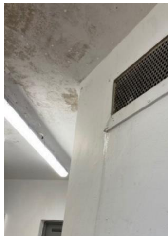
Mur et plafond humides
