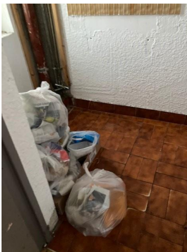
Poubelles des cellules entreposées à même le sol
