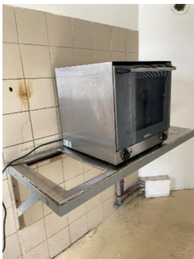
Plaques chauffantes manquantes
