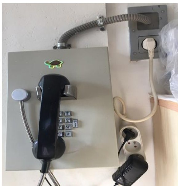
Poste téléphonique installé dans une cellule
