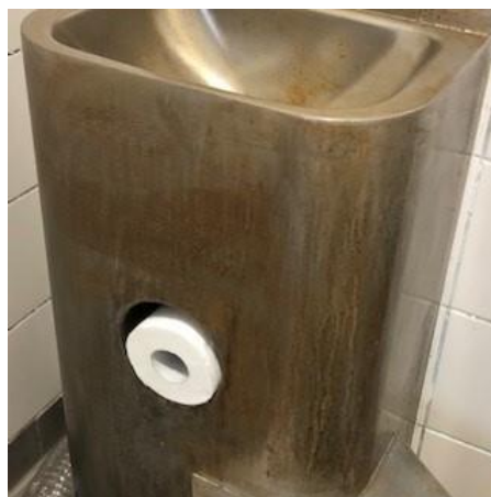
G06- CI n°2- Etat rouillé du bloc sanitaire
