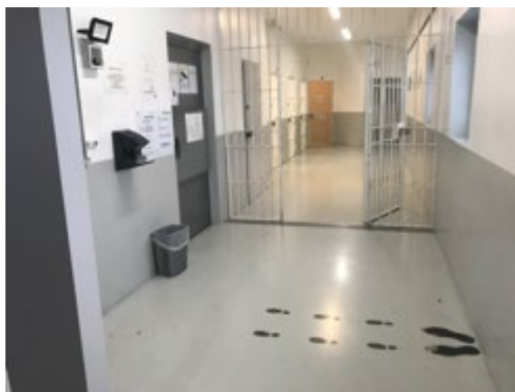
Le guichet du greffe et le couloir s'ouvrant sur les cellules d'attente
