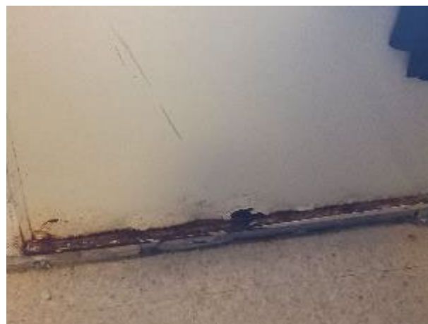
Cellule n°324, importante superficie de moisissures (rejet du recours fondé sur l'article 803-8 du CPP)
