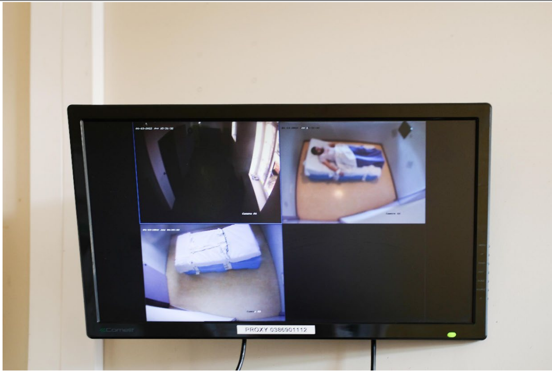
Vidéosurveillance des chambres d'isolement dans un hôpital psychiatrique (© T. Chantegret pour le CGLPL.)
